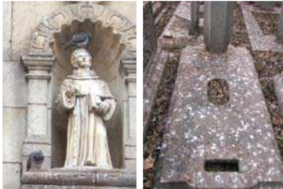
Şekil 2.13. Bogota'daki San Francisco Kilisesinin giriş kapısındaki mermer heykelin bulunduğu nişte görülen güvercin dışkıları (solda). Tarihi mezar taşında güvercin ve kuş pisliklerinin verdiği zarar (İstanbul).
