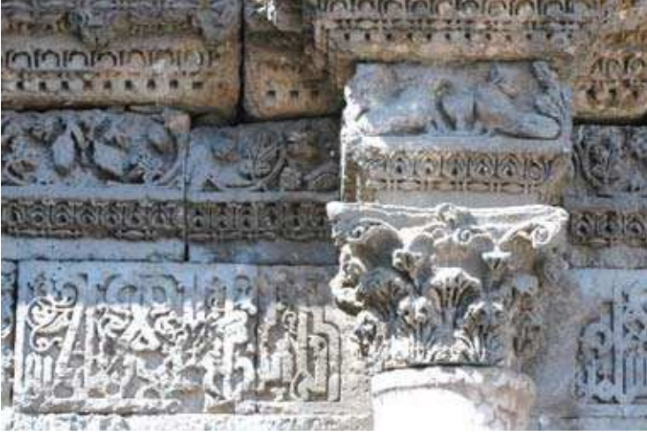
Şekil 3.27. Diyarbakır Ulu Cami sütunlarından birinde, erozyon sonucunda sütün başlığında görülen yuvarlaklaşma.
