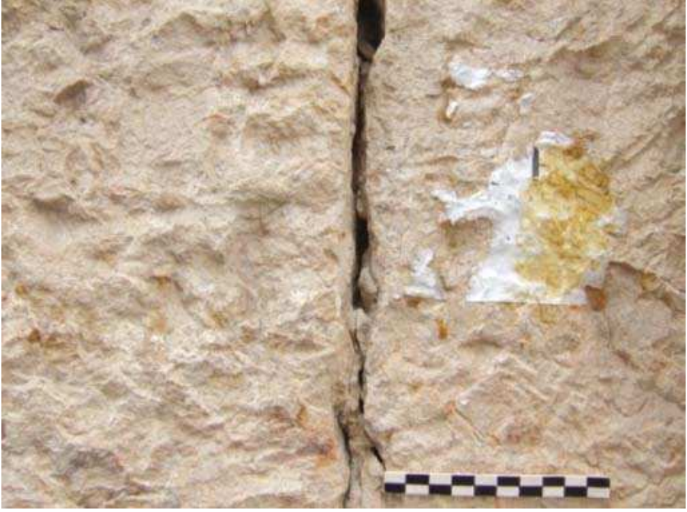
Şekil 3.61. Yasak edilmesine rağmen kilise cephesinde görülen duvar afişlerinin yarattığı kirlilik.
