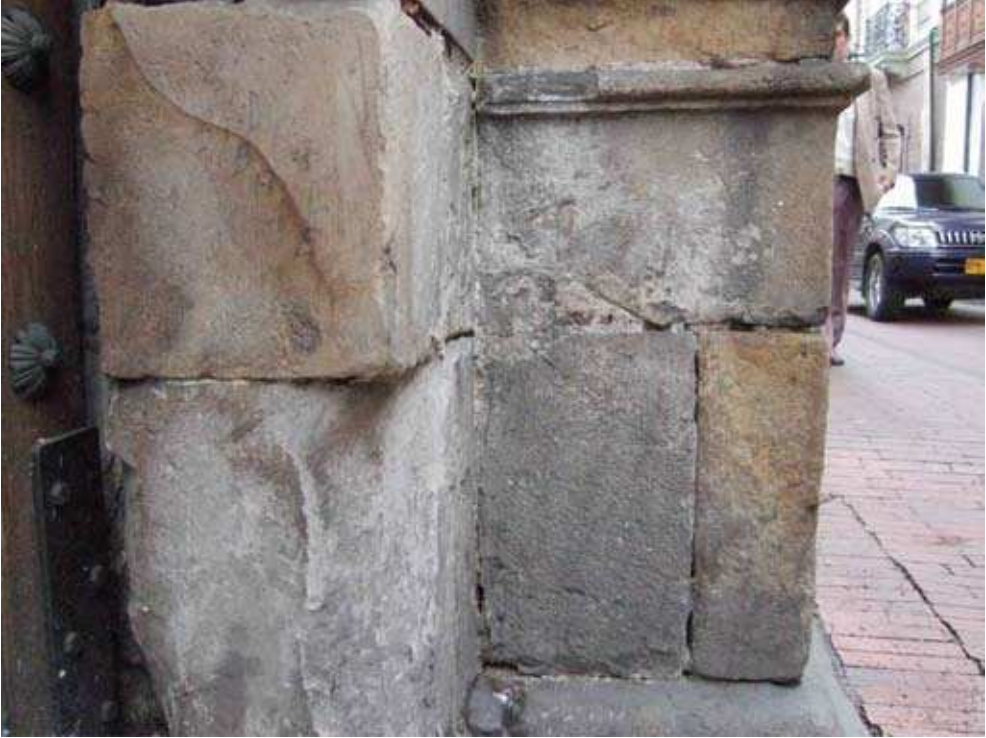
Şekil 2.18. Bogota'da taşıt trafiğine açık olan eski kolonyal mahallesinde, yolun hemen kenarındaki Rosario KİLisesinin duvarlarında gözlenen hava kirliliğinin neden olduğu lekelenme, renk değişimi ve erozyon gibi, değişik türdeki bozunmalar.
