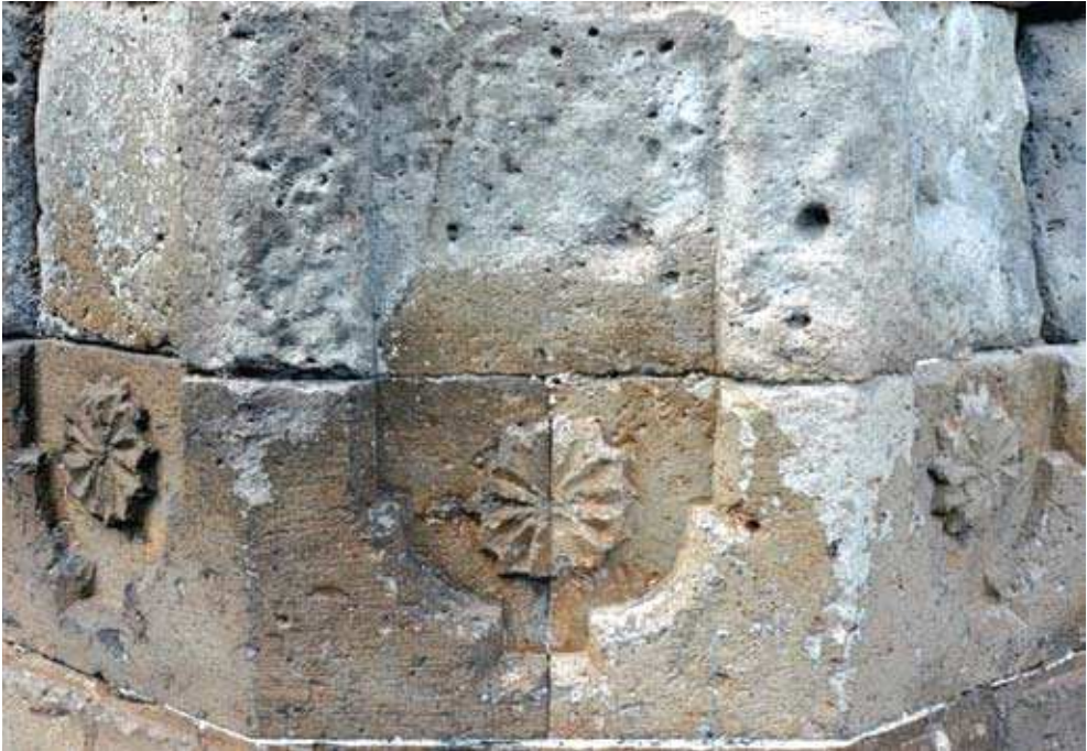
Şekil 3.36. Bitlis İslahiye Şeref Han Medresesi duvar taşlarında görülen beyaz renkli kabuk oluşumu.
