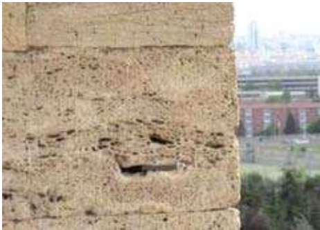
Şekil 1.16. Ankara/Anıtkabir'de traverten yapı taşlarında görülen dokusal bozunmalar (Akin, 2008).
