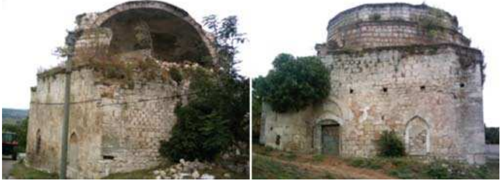
Şekil 1.10. Kırklareli/Vize Şerbetdar Hasan Bey (Paşa) Camii bakımsızlıktan dolayı yok olma ile karşı karşıya bırakılmıştır. Yapıda yoğun olarak zeminden kaynaklanan oturmalarından dolayı açılmalar ve bitkilerin oluşturduğu hasarlar, su-nemin yapı taşlarında oluşturduğu alterasyonlar yoğun olarak görülmektedir. Yapıda kullanılan kireçtaşları atmosferik hava koşulları ile mücadele ederek günümüze kadar ayakta kalmayı başarmıştır (Dal, 2008).
