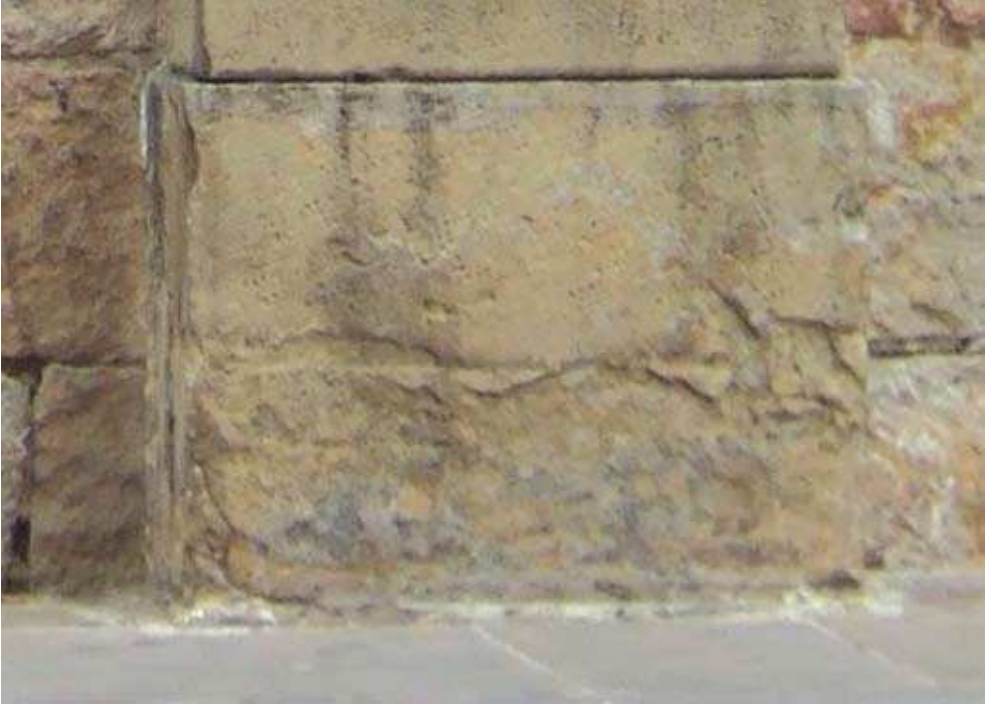
Şekil 3.23. Duvar cephesinin zemine yakın olan bölgedeki taşlarda sık görülen ve yerle birleştiği bölümlerde yoğunlaşan aşınmalar.
