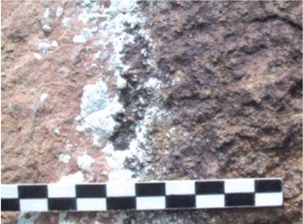
Şekil 3.50. Açık havada sergilenen kumtaşında yapılmış monolitlerde görülen tuz kristallenmesi (Infiernito, Kolombiya).
