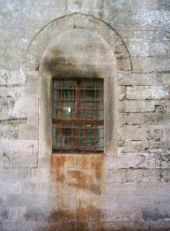
Şekil 2.16. Kırklareli Hızır Bey Hamamı'nda görülen metallerin korozyona uğraması ile yapı cephesinde görülen pas ve is lekelerinin oluşturduğu tahribat.
