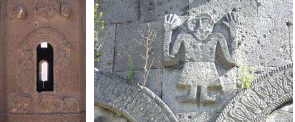
Şekil 3.32. Van Akdamar Kilisesi (solda) ile Kars'taki Havariler Kilisesi duvarlarını oluşturan taş yüzeyinde mekanik etkiler sonucunda oluşan delikler.
