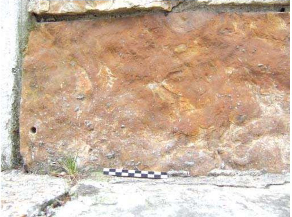
Şekil 3.24. Taş yapısından bağımsız olarak gelişen rölyef şeklindeki bozunma.
