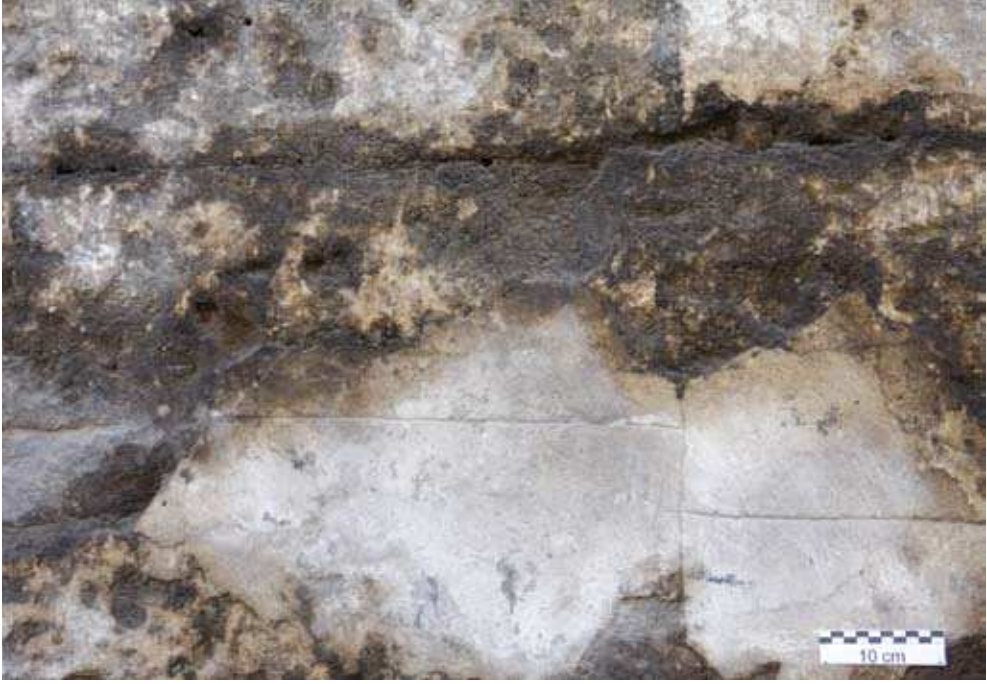
Şekil 3.35. Kırklareli Hızır Paşa Külliyesi Hamamının kuzey cephesindeki duvar taşlarında görülen siyah renkli yoğun kabuk oluşumu.
