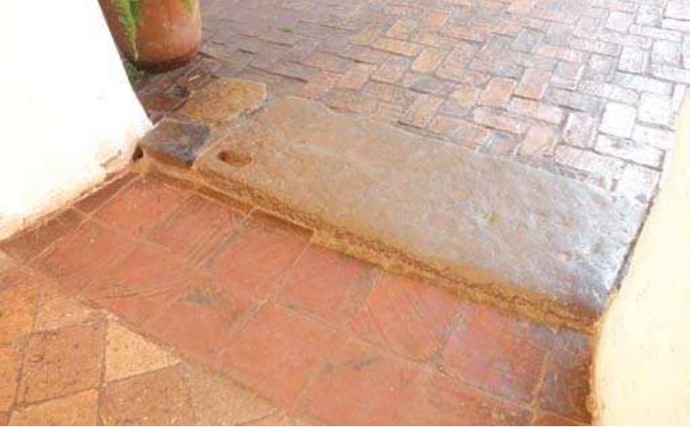
Şekil 3.33. Bir kolonyal şehir olan Villa de Leyva'da (Kolombiya) bulunan sayısız anıt eserlerden birinde, alışveriş merkezi olarak kullanılmasından dolayı ziyaretçilerin neden olduğu eşik taşındaki aşınma.
