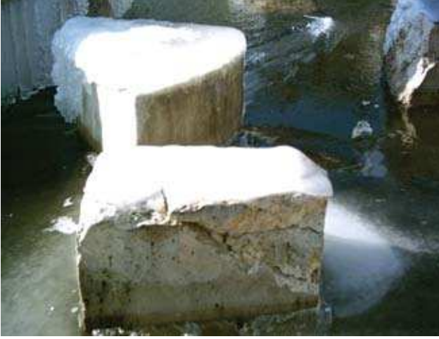
Şekil 2.4. Kırklareli merkezde, kış mevsiminde Pınarhisar kireçtaşının don sonrası taşlarda görülen büyük parça kopmaları şeklinde oluşan hasarlar.
